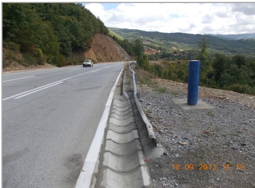
Слика 2 Оштетувања на патната конструкција
