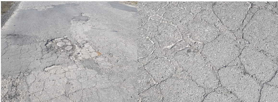
Слика 3,4 Оштетувања на патната конструкција
