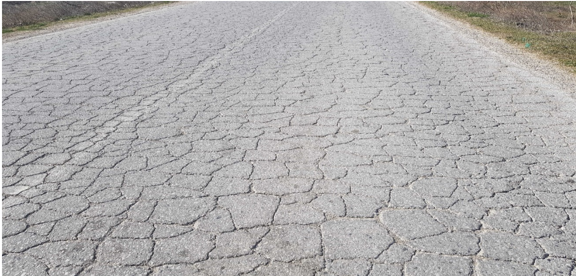
Слика 2 Постојна состојба на пат – оштетување, мрежасти пукнатини по целата должина
