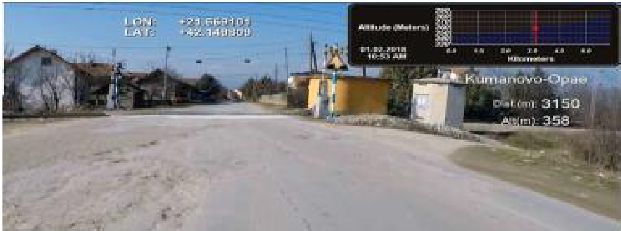
Слика 4 - преминот преку железничката пруга и оштетениот коловоз во овој дел од патот е значаен и опасен за безбедноста во сообраќајот, особено во текот на ноќта.
