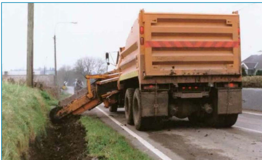
Figure 44 Изведба на отворен канал на подрачја каде трасата се води во мал усек
