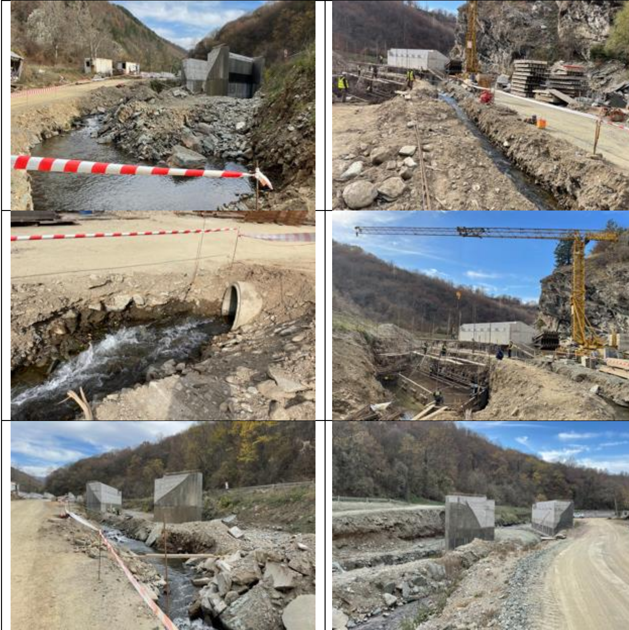
Слика 1, 2, 3, 4, 5 и 6. Изградба на стопи за мостови Figure 1, 2, 3, 4, 5 and 6. Construction of footings for bridges
