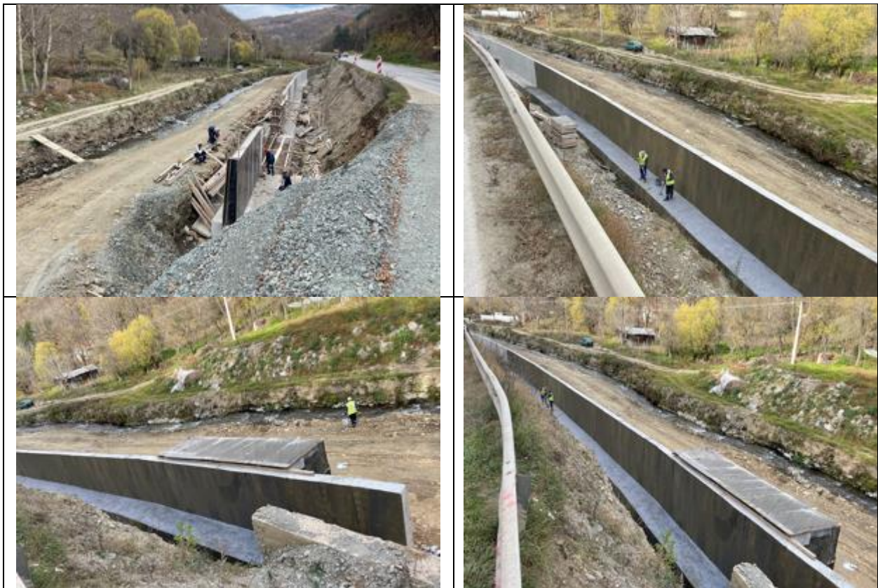
Слика 7, 8, 9 и 10. Изградба на потпорните ѕидови Figure 7, 8, 9 and 10. Construction of retaining walls
